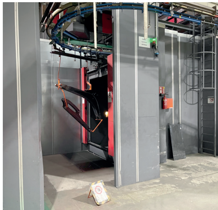
In der Hängebahnstrahlanlage sorgen installierte Sensoren u.a. im Strahlbunker, im Turbinenbereich und im Windsichter dafür, den Prozess bewertbar zu gestalten.
